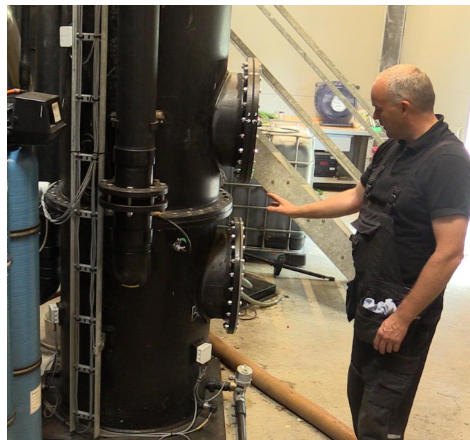
Gasrenser på Foulum Biogas
