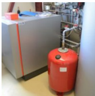
Et gyllekølingsanlæg består af PEL-slanger i gulvet under gyllen samt en varmepumpe, der trækker varmen ud af vandet. Kilde: Byggeri & Teknik
